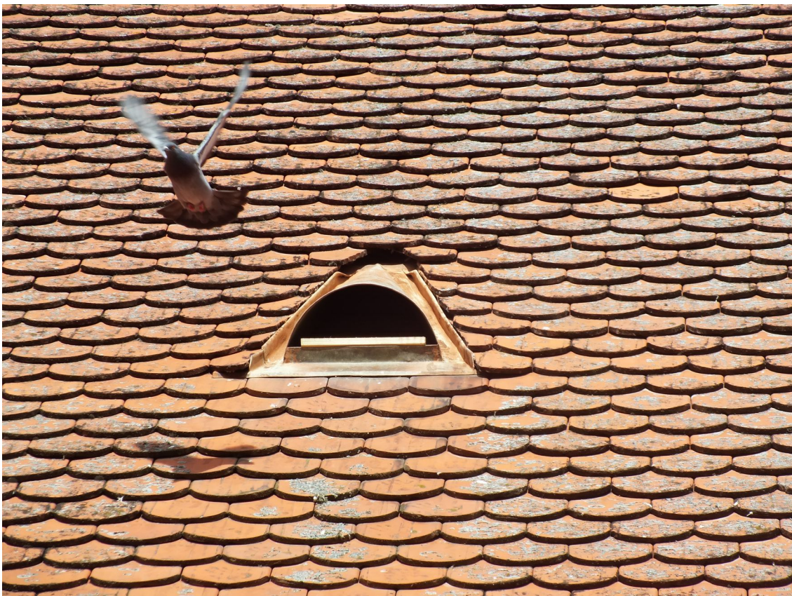
Abb. 22 Die Einflugsöffnungen der Fledermäuse werden oft auch von Tauben genutzt. Der Verschluss kann zu einem Problem werden und eine taubensichere Lösung ist nicht immer möglich. Foto: K. Bürger
